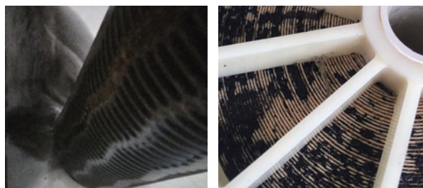
图 4 保安过滤器滤芯和一段膜元件污堵情况
